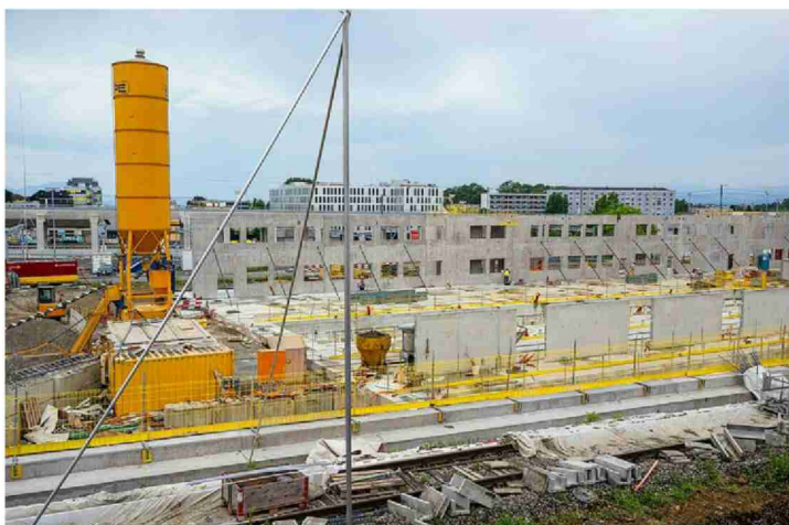
Les murs du futur garage-atelier des tramways commencent à être érigés, non loin du viaduc.
