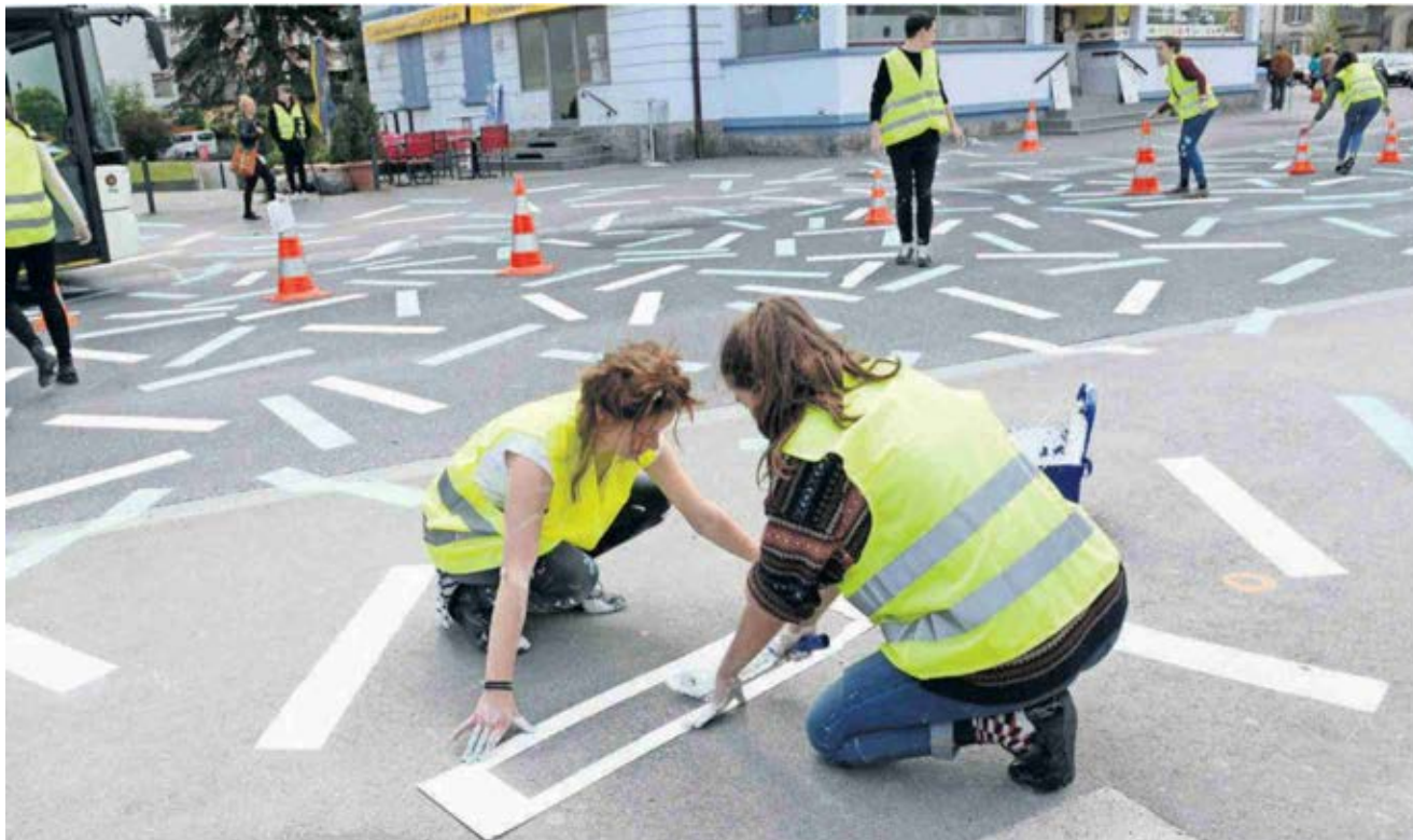
Des étudiants de l'EPFL imaginent et construisent des aménagements d'une zone de rencontre temporaire à la place de la Gare de Renens. PHILIPPE MAEDER
