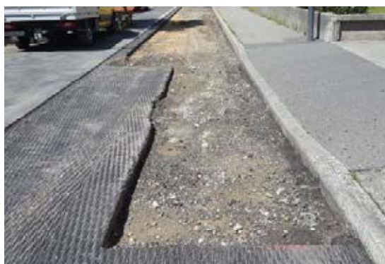
Purge chaussée 24-Janvier
