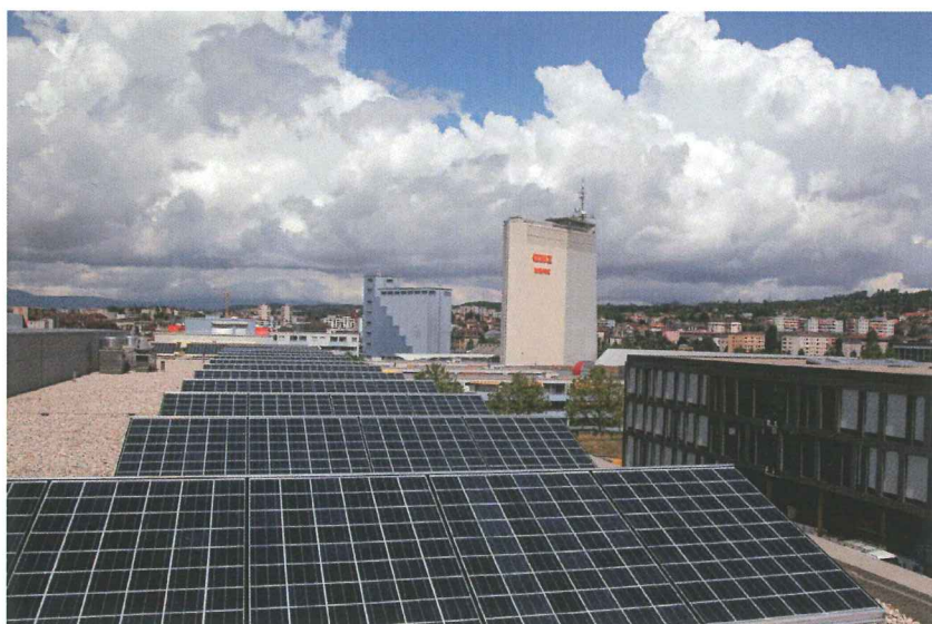
Panneaux solaires sur le Bâtiment Vaudaire du Collège du Léman.
