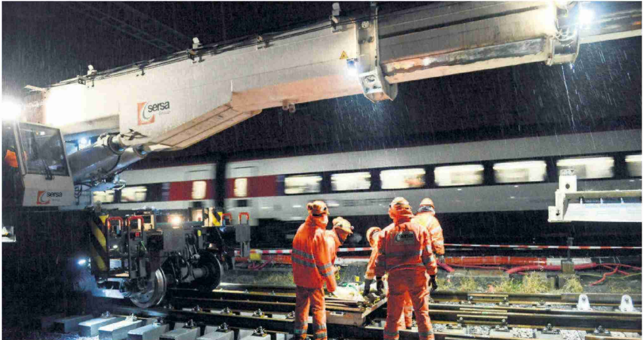
Les ouvriers posent la 4e voie entre Lausanne et Renens à côté d'une voie en exploitation. Le travail nocturne permet de limiter les perturbations du trafic.
